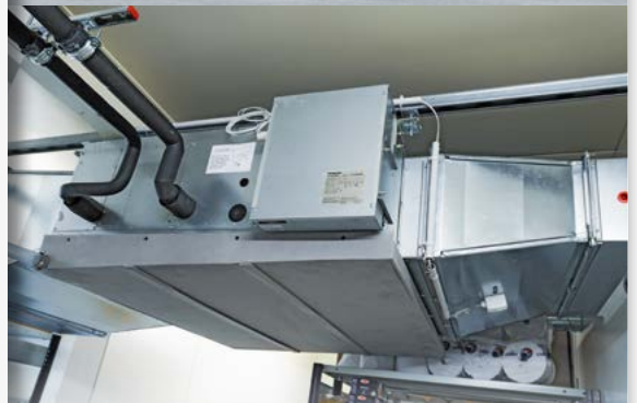
Lüftungsmonobloc zum Heizen und Klimatisieren des Shops.
