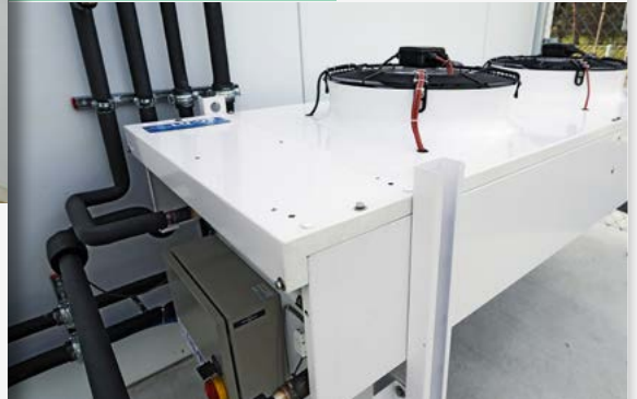
Gaskühler zur Abfuhr der Restwärme.
