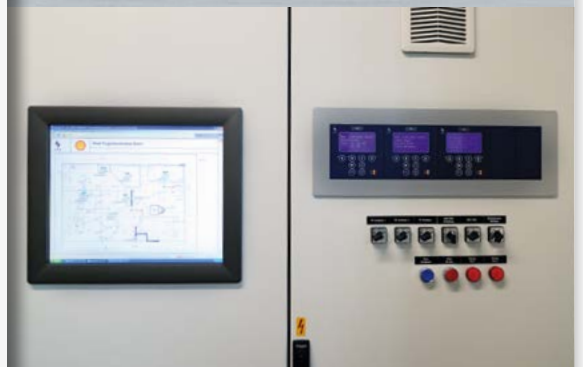
Schaltschrank mit Leitsystem und Fernüberwachung.
